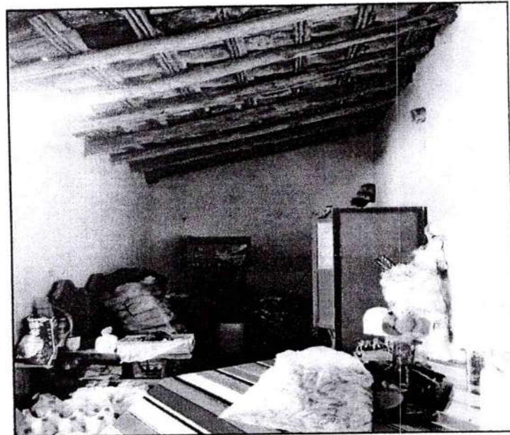
Fig. 2.0. Daños en el interior del Terremoto-2.
